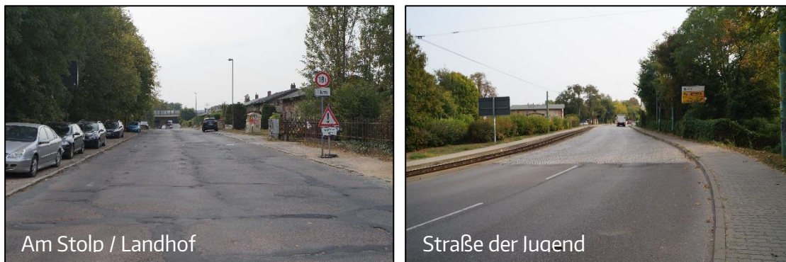
Abb. 6 Oberflächendefizite im Landesstraßennetz
