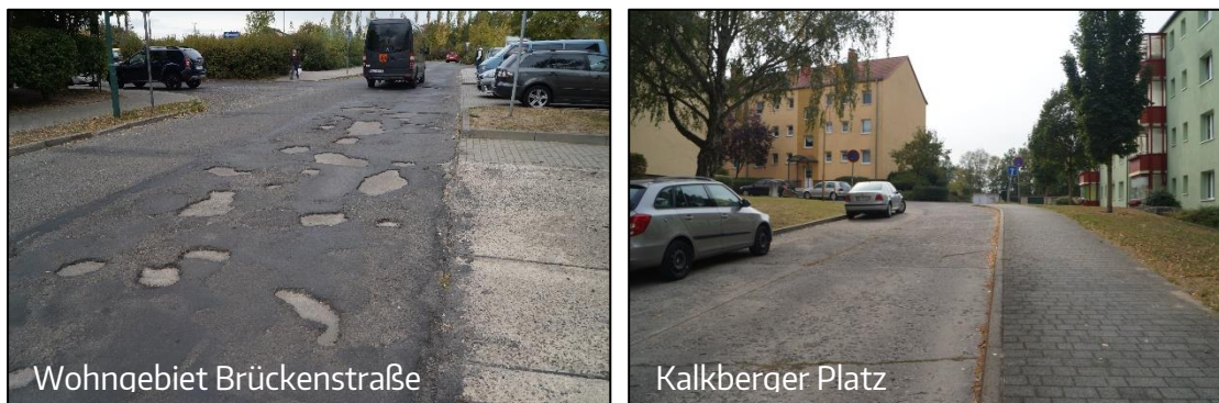
Abb. 7 Oberflächendefizite im Anliegerstraßennetz
