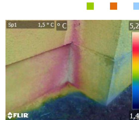
An dieser Ecke dringt nicht nur Wärme nach draußen, es kann auch Feuchtigkeit ins Mauerwerk eindringen. Hier droht Schimmel.
